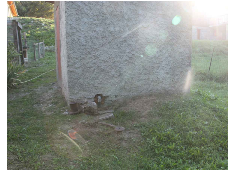
Vue extérieur du local du surpresseur
